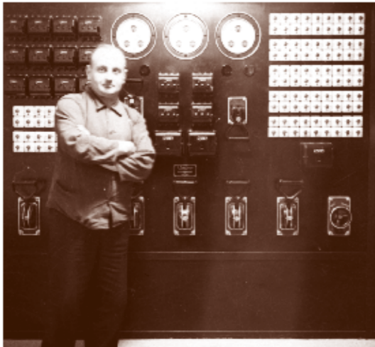
Herr Schreiber, Angestellter der Firma Karl Oppermann vor einem Schaltraum in der Rautenbach-Villa.
