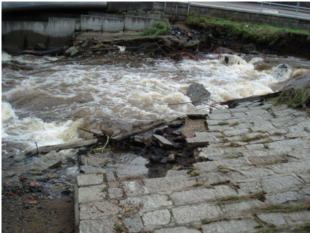
Abbildung 4.1: Die Reste des im Juli 2017 durch ein Hochwasserereignis fast vollständig zum Einsturz gebrachten Querbauwerks H4 in der Holtemme. Im Hintergrund ist der Einstieg in die weitgehend unbeschädigt gebliebene FAA zu sehen, die durch den Wegfall des Querbauwerks vorübergehend obsolet gemacht wurde.
