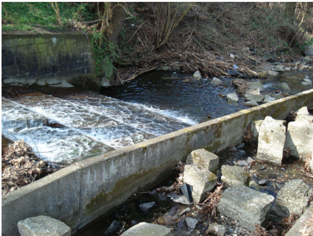
Abbildung 6.7: Ein durch Treibgutverstopfung und Niedrigwasser weitgehend trockengefallener Rauhgerinne-Beckenpass im Zillierbach (Z4), der seine Funktionsfähigkeit temporär eingebüßt hat.
